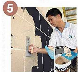
5 ฉาบเต็มชั้นแรก ด้วยสีทีโอเอ เดคอร์แซนสโตน ด้วยเกรียง ฉาบขัดมัน
